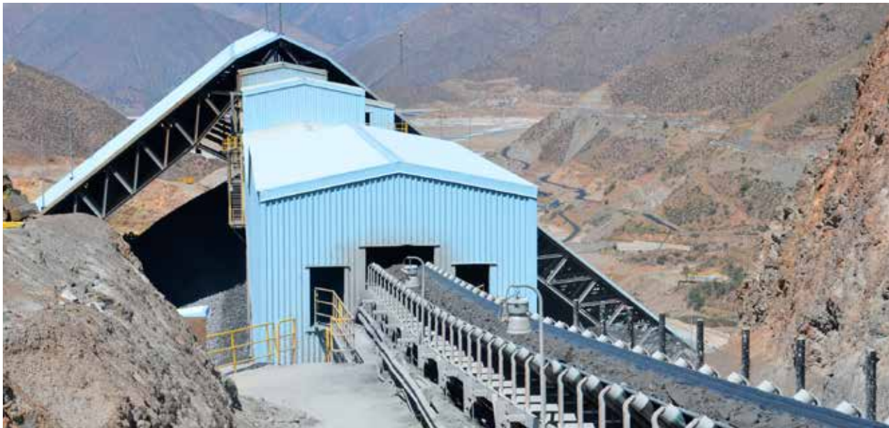
Desde el año 2000, Minera Los Pelambres aprovecha la energía que se genera al frenar las correas que transportan el mineral de la mina a la planta para generar electricidad.
