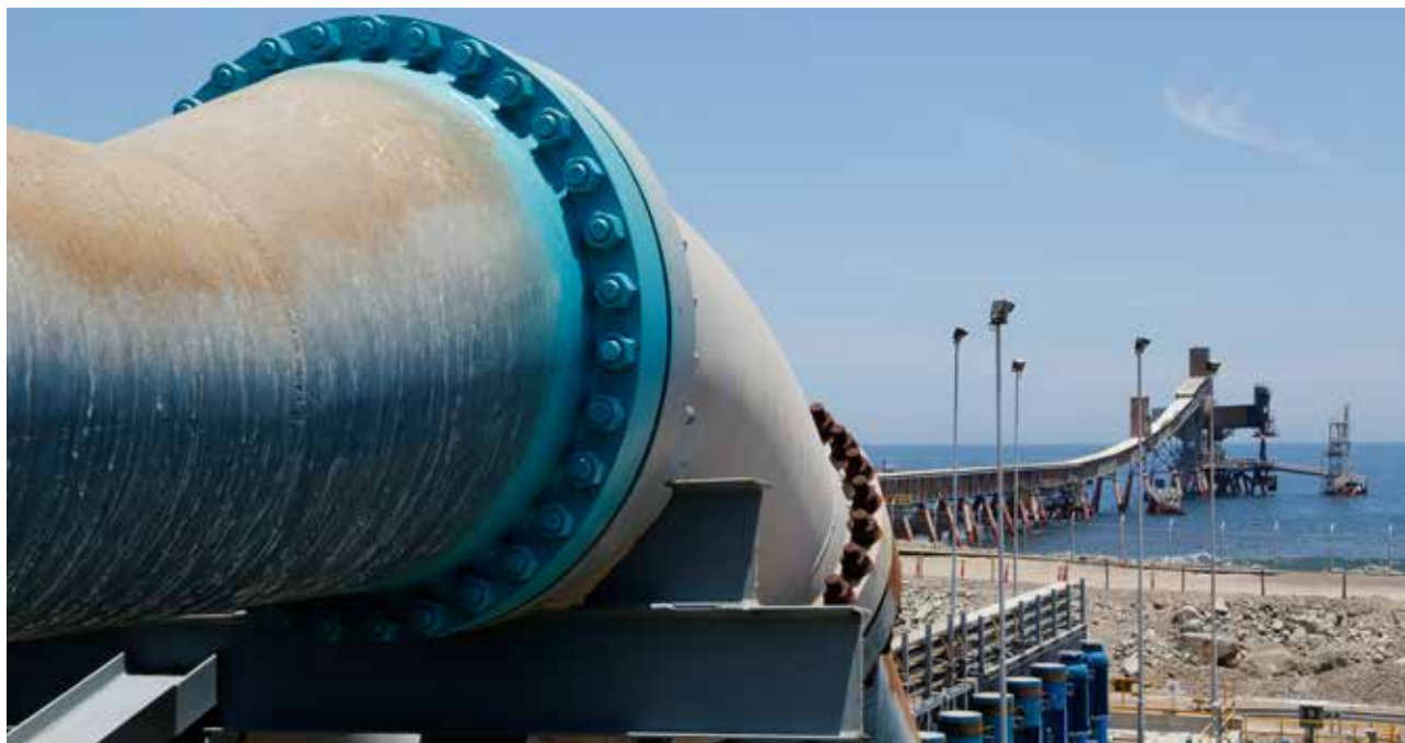
Extracción de agua en muelle de Minera Centinela.
