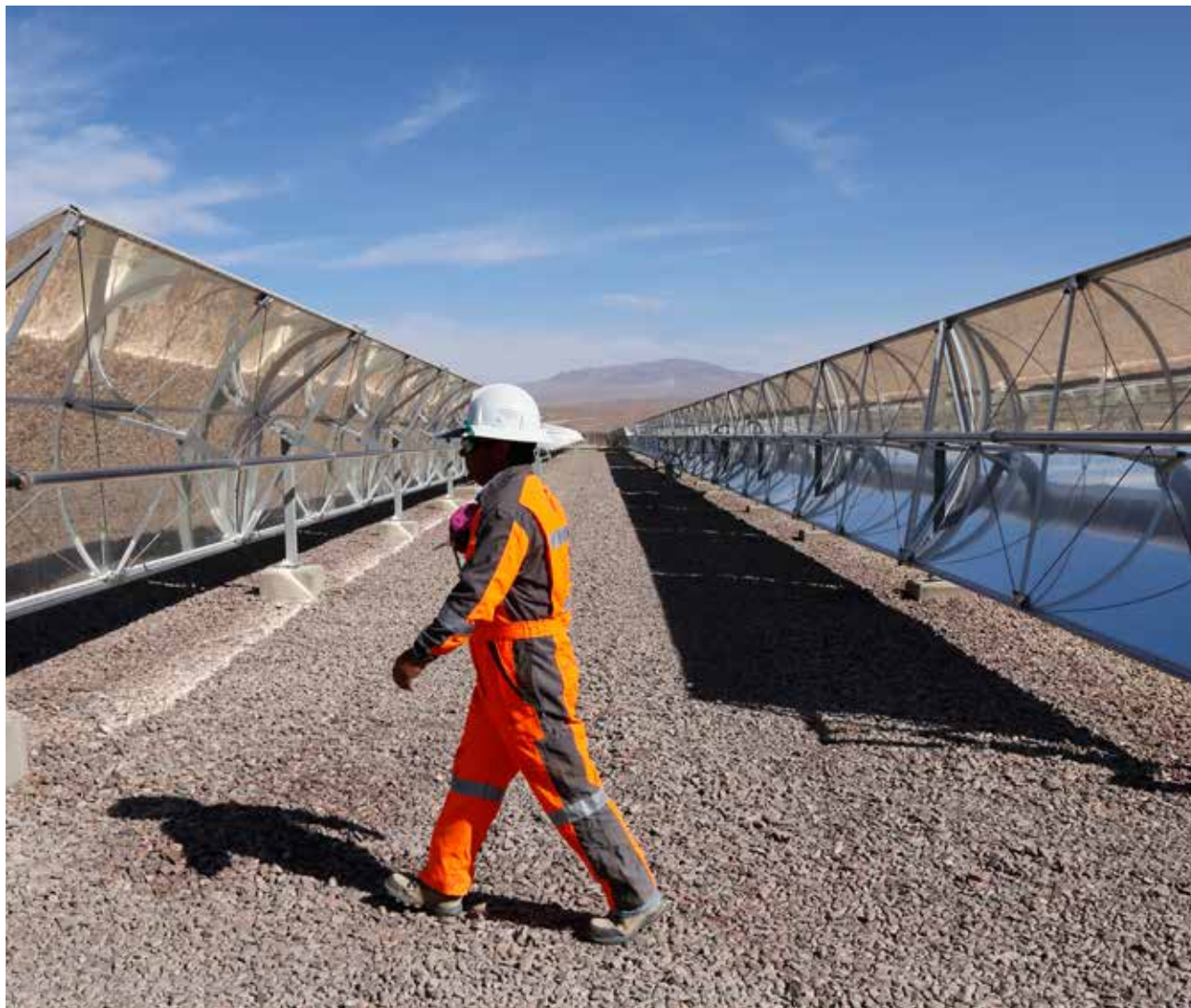
Planta termosolar Centinela.
