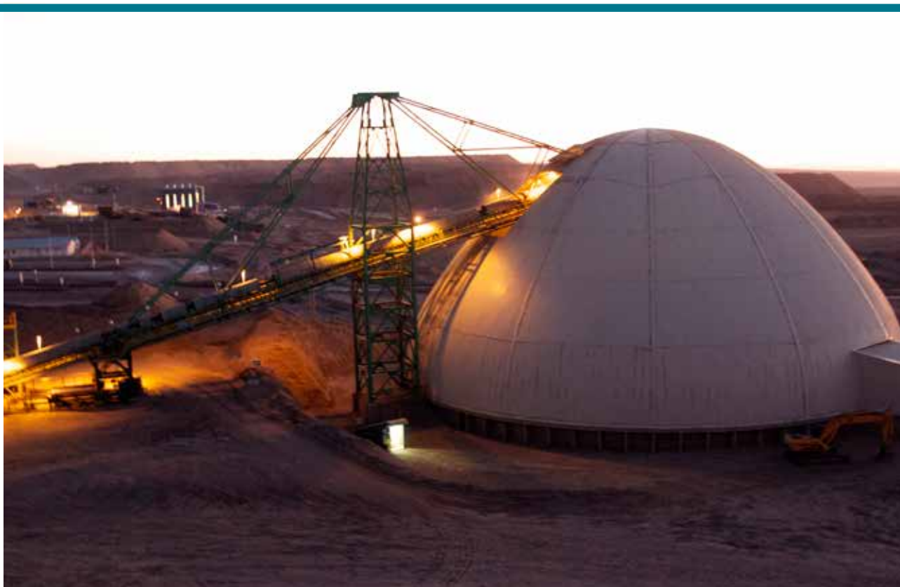
El año 2014 se completó la construcción del domo que cubre el stockpile de Centinela.
